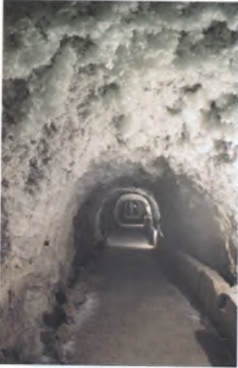
Кристаллы на своде выходного тоннеля
