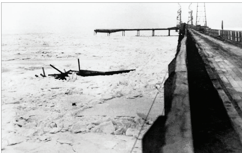
Рис.13. Разрушение эстакады на месторождении Инчхе-море, февраль 1953 г. (Фото из архива ПАО «Роснефть-Дагнефть»).
