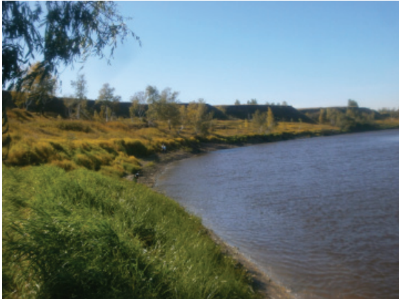
Река Омь. Оползень
