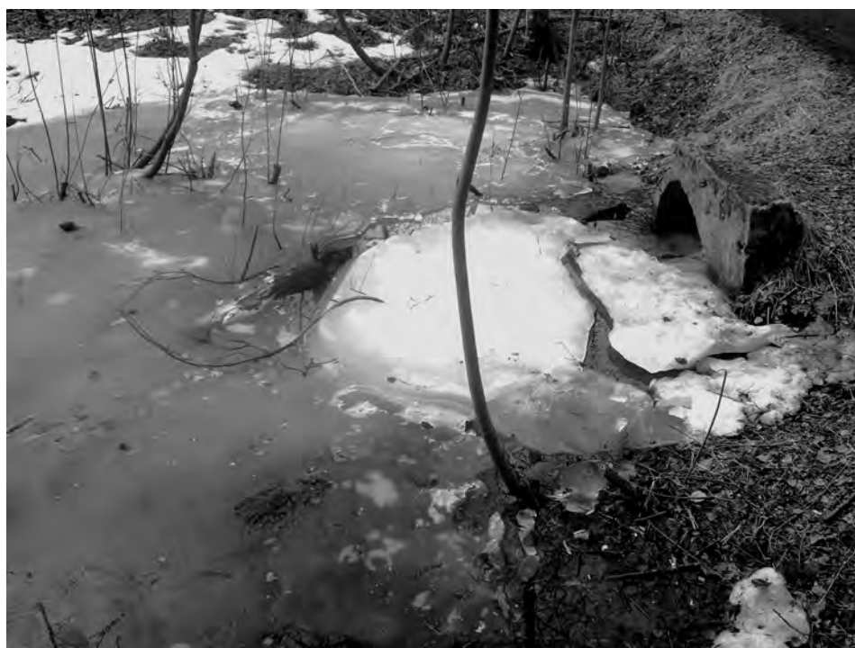
Рис. 3.6. Наледи на водопропускных сооружениях в истоке ручья Костянка.
